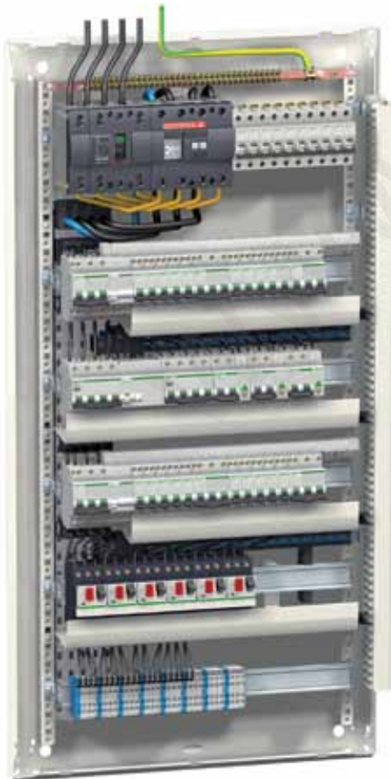
NG160 в модульном шкафу
