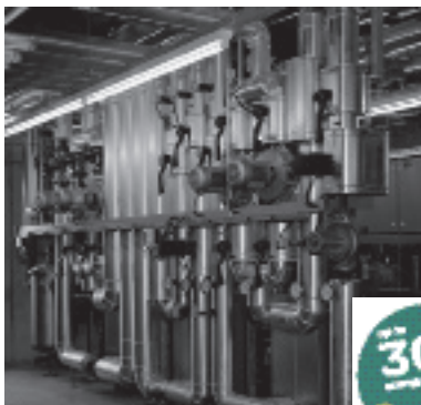
Управление насосной станцией
