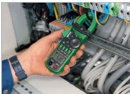
Измерения тока в распределительном шкафу
