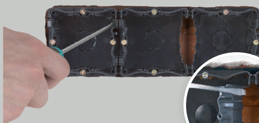
Установка механизмов Simon 82 Centralizaciones
