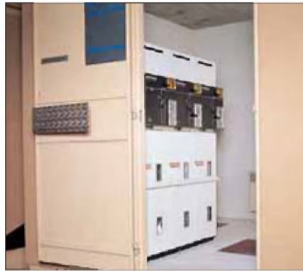
Подстанция, полностью смонтированная на заводе
