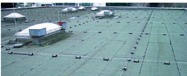
Молниеприемная сетка на плоской кровле
