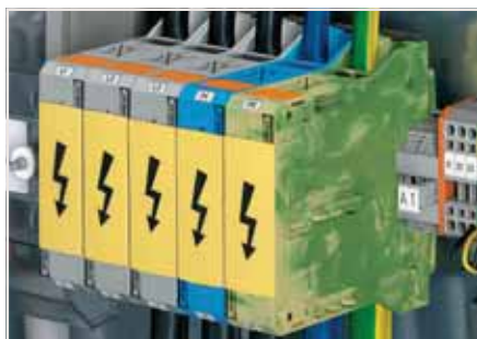
Защитный предупредительный маркер может сообщать следующее: Например: питание подаётся даже после перевода основного выключателя в положение ОТКЛ!
