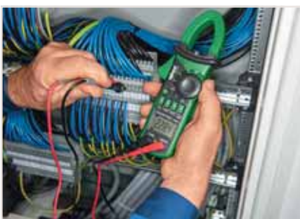
Измерение тока в распределительном шкафу
