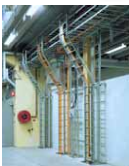
Кабельные лестницы и лотки
