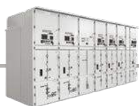
Распределительное устройство в металлической оболочке
