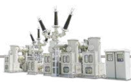
КРУ с газовой изоляцией
