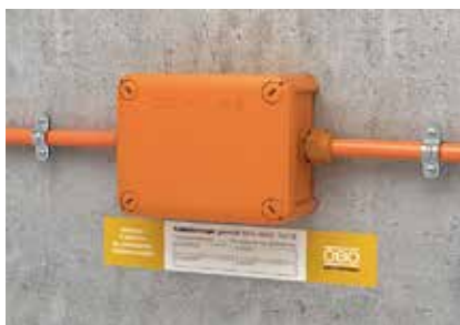
Установленная огнестойкая распределительная коробка FireBox с маркировкой.
