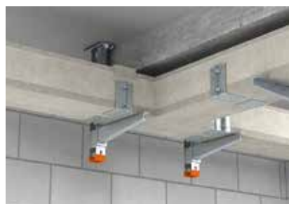
Предварительно смонтированные стандартные фасонные детали в трассах.
