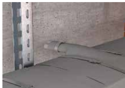
Кабельный вывод с бандажированием.
